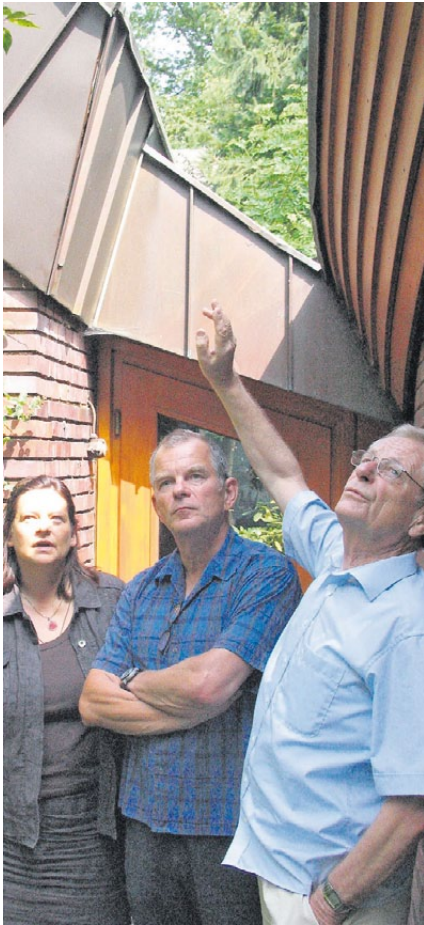
Pfarrerin Jeanette Terra sowie Werner Möller und Joachim Stams begutachten den Zustand des Kirchendaches. RN-Foto cm
